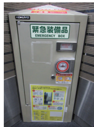
エレベーターに設置されている防災キャビネット
